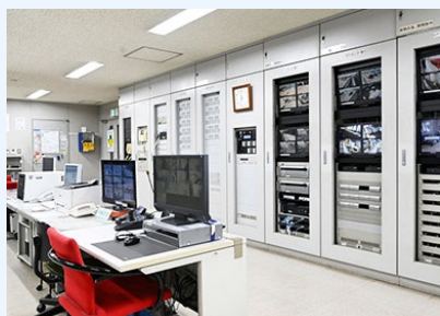
防災センター
